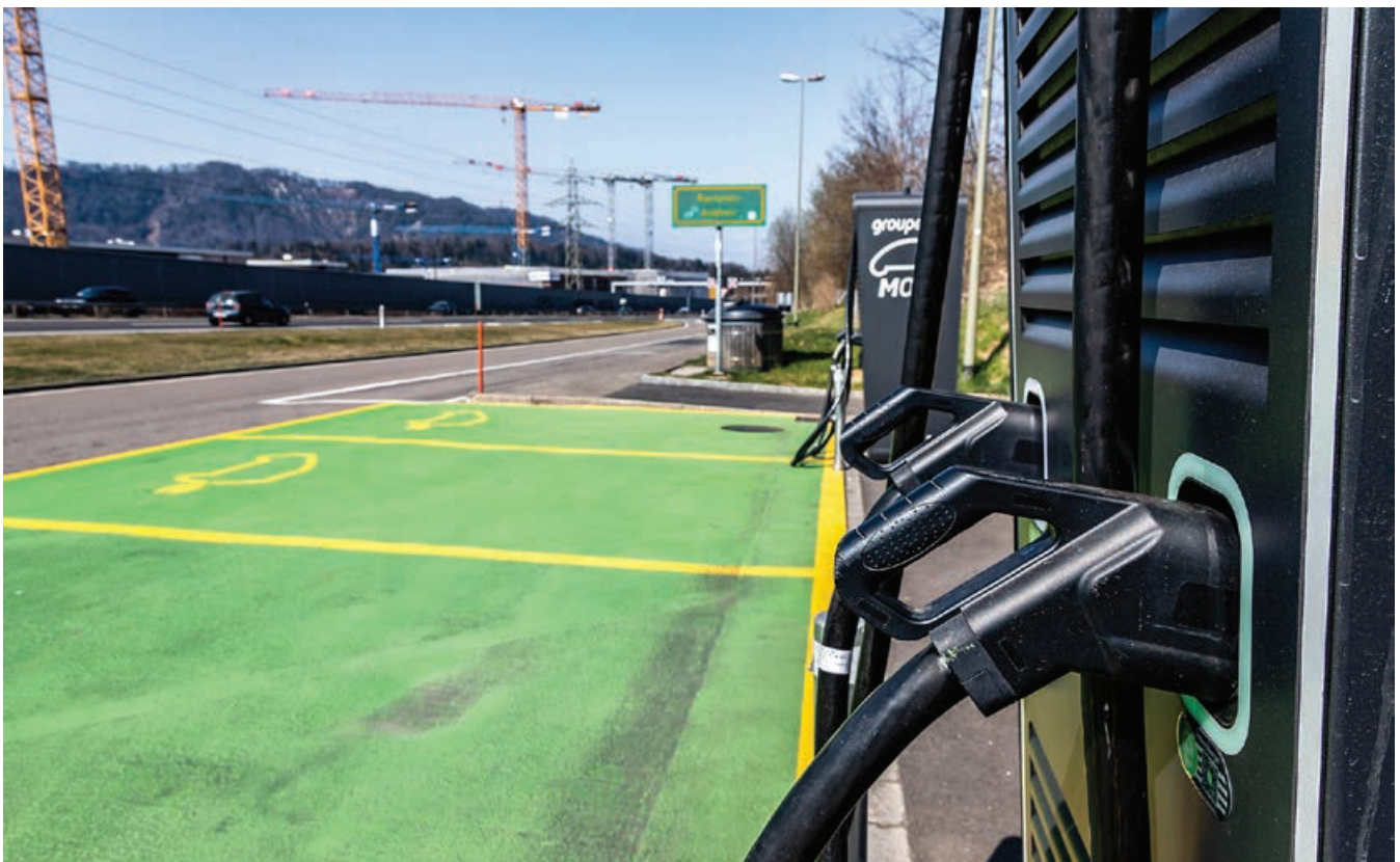
Die Elektro-Schnellladestation auf dem Rastplatz Aspholz auf der A3 bei Adliswil.
