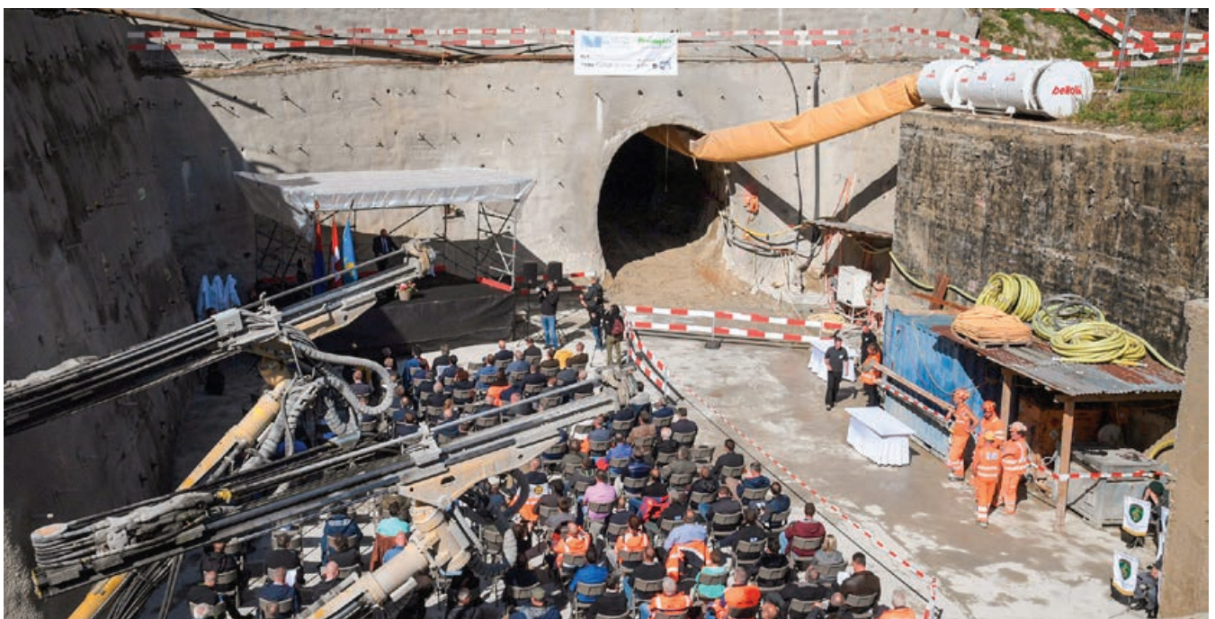
Bau der zweiten Röhre des Gotthard-Strassentunnels: Spatenstich am 29. September 2021 am Südportal in Airolo. Gleichentags fand auch eine Zeremonie am Nordportal in Göschenen statt.
