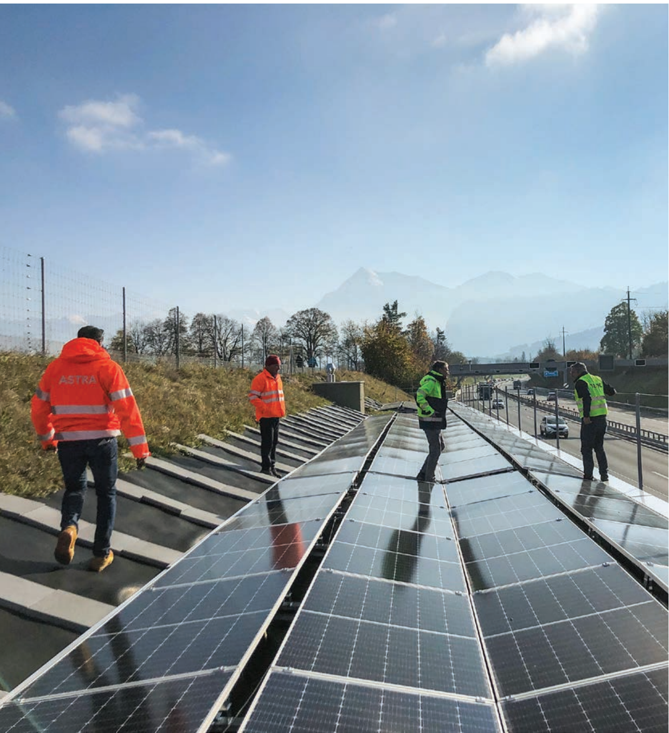
Die Photovoltaik-Anlage auf dem Gebäude der Zentrale des Allmendtunnels in Thun.
